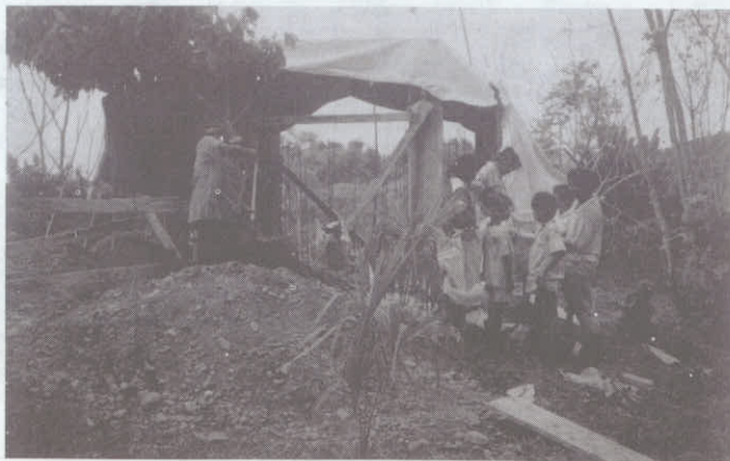
Tanque de almacenamiento. Volumen 22.500 litros Comunidad de Watsi
